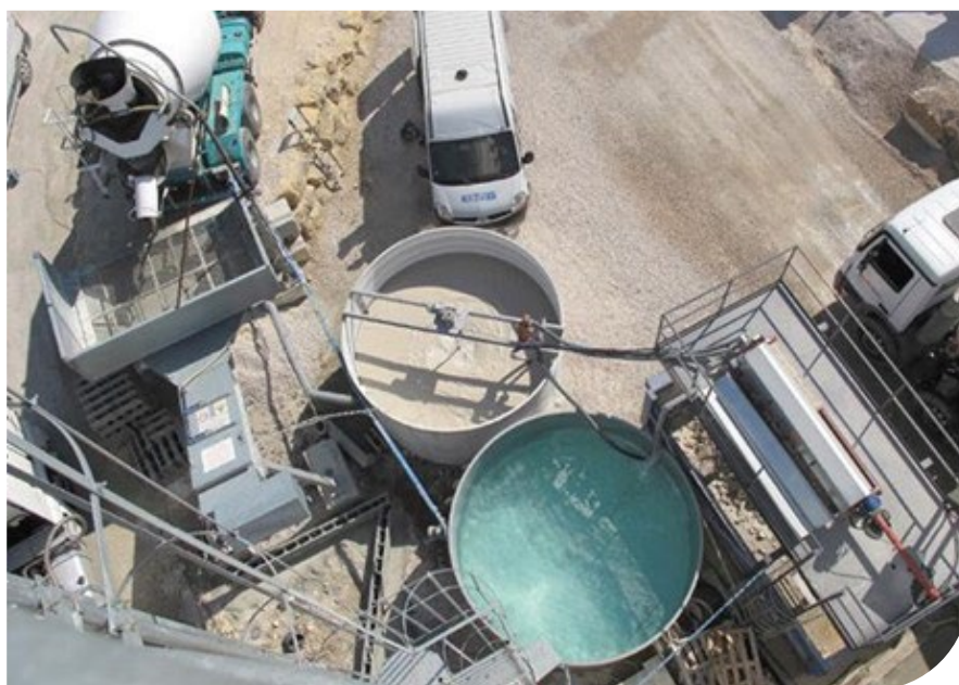
Figura 4.5. Planta de tratamiento de agua residual en una planta de concreto.
